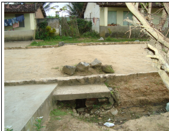
Boca de lobo danificada.
