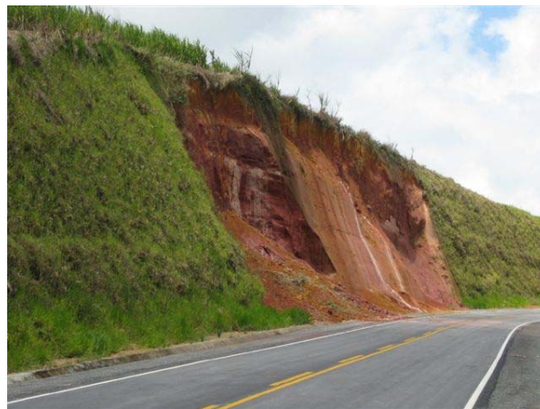
Foto 05: km 11,3 (erosão na margem da rodovia)
