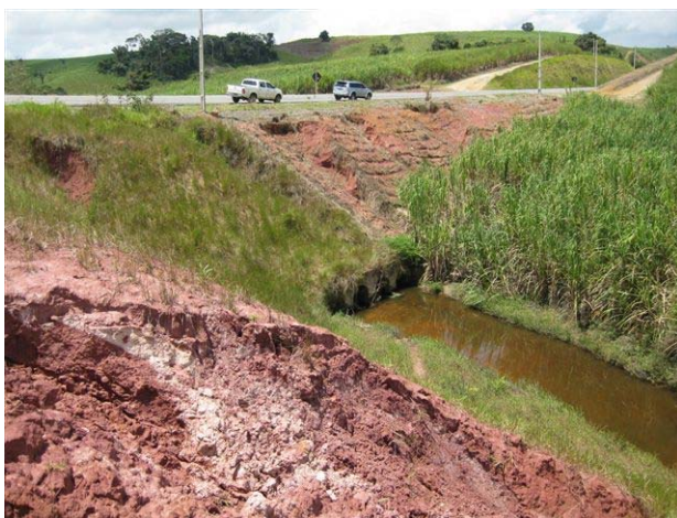
Foto 06: km 10,5 (bota-fora nas proximidades de córrego, com erosões e assoreamento)
