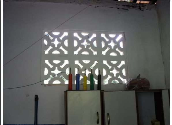
Janela sem tela de proteção para impedir a entrada de insetos, roedores e aves.
