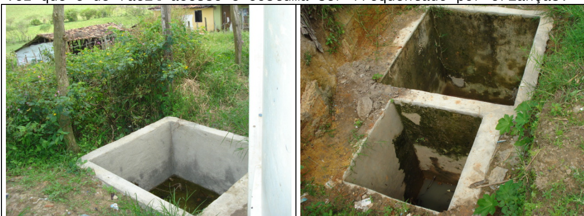
Leito de secagem do lodo, ainda sem utilização, representa risco às crianças da localidade.
