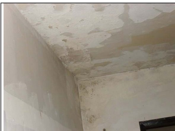
Teto do Armazém Geral da prefeitura utilizado para a guarda dos alimentos apresentando infiltrações.
