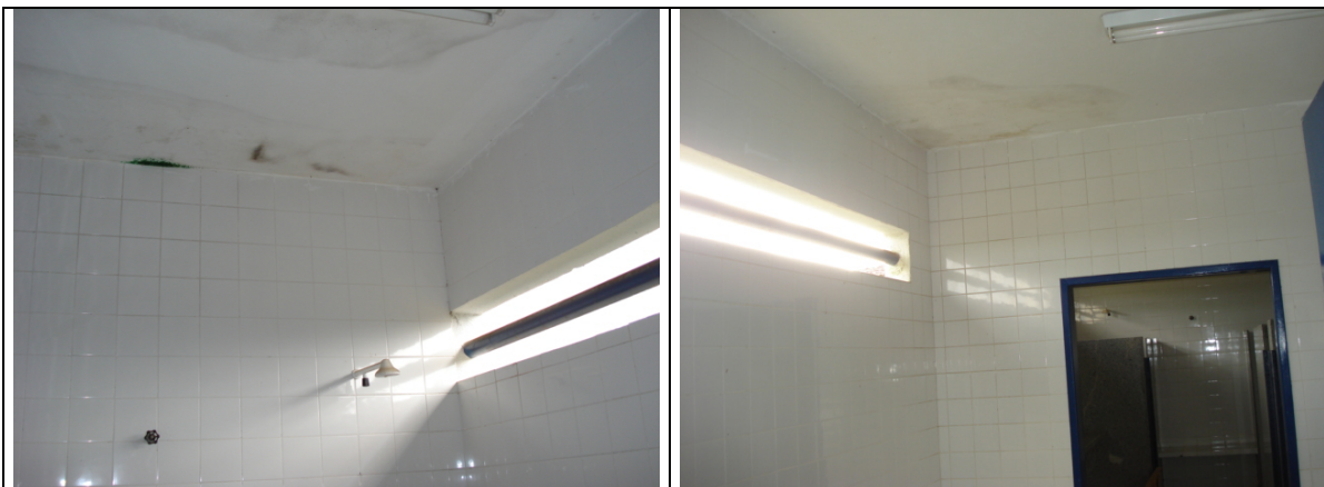
Infiltrações no teto do vestiário feminino
