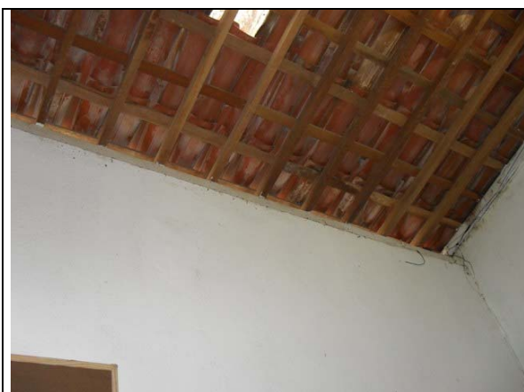
Teto do local onde são armazenados livros e alimentos sem forro.
