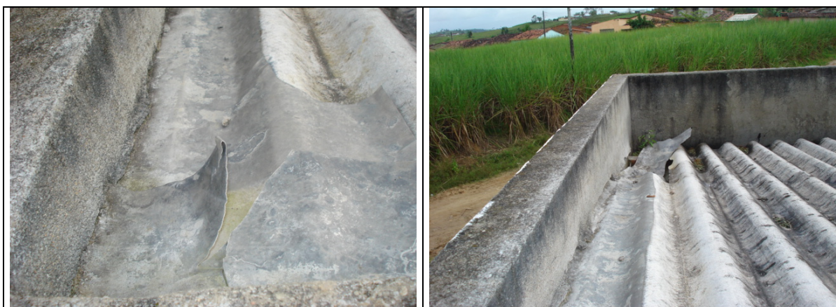
Detalhes do telhado, com telhas danificadas.
