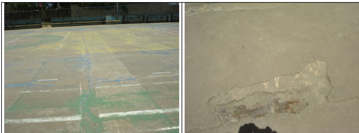
Rachaduras no piso da quadra do Povoado Canastra.
