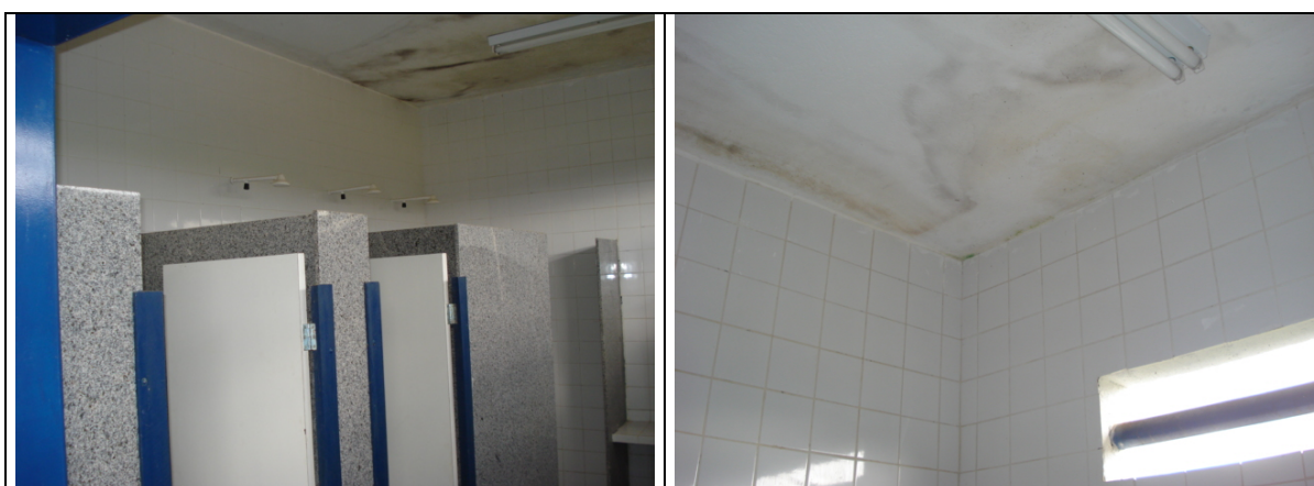
Infiltrações no teto do vestiário masculino
