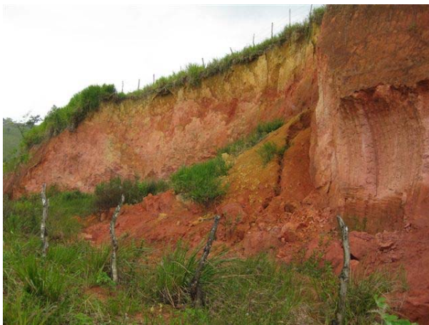
Foto 04: km 2,9 (erosão na margem da rodovia)
